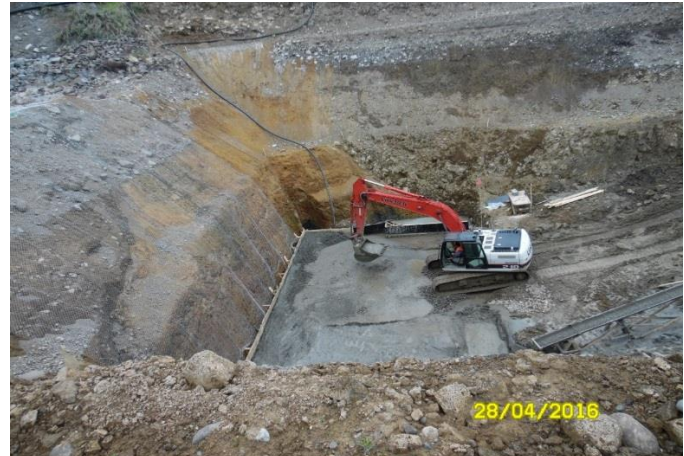
Hormigonado del Radier de 70 cm. de la Casa de Máquinas de la Central Hidroeléctrica Convento Viejo.
