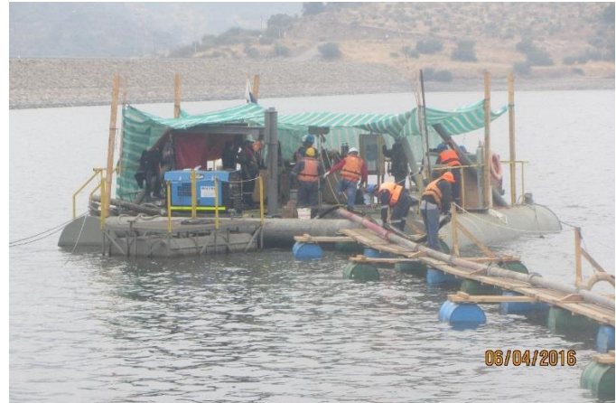
Hormigonado de los Pilares de Sello del Moldaje Modular. Vista de la Pasarela Flotante y de la Balsa de Trabajo.
