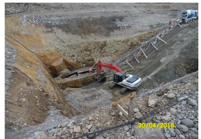
Hormigón pobre con bolón desplazador, para el mejoramiento del Suelo de Fundación de la Casa de Máquinas
