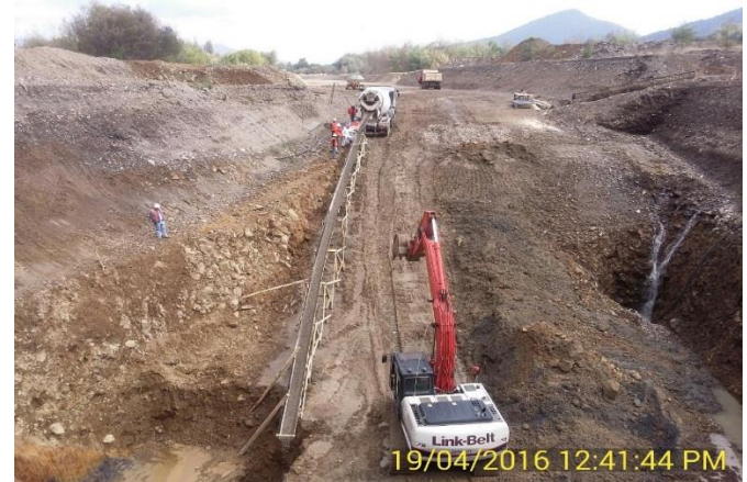
Hormigonado, con hormigón pobre y bolón desplazador, de las Calicatas del mejoramiento del Suelo de Fundación de la Casa de Máquinas
